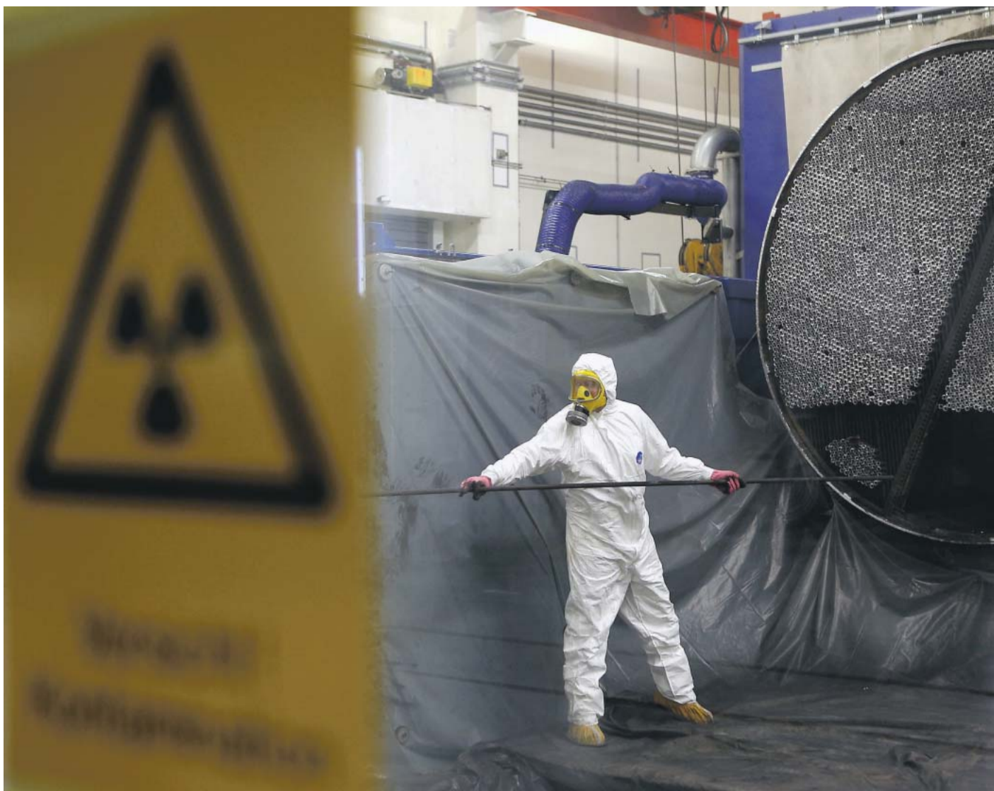
Gefährlicher Müll: Ein kontaminierter Dampferzeuger aus Obrigheim wurde ins Zwischenlager Lubmin verbracht, wo er auseinandergenommen wird
